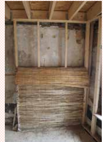
▲ Des caissons remplis de chaux-chanvre assurent efficacement l'isolation intérieure de la façade avant.
